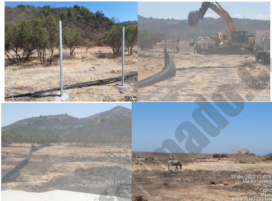
Figura 3. Estado actual de la malla en algunos sectores y animales en obra Fuente: registro fotográfico terreno.
