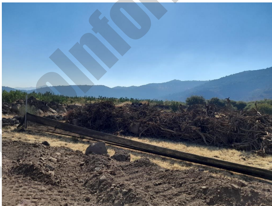
Figura 4. Estado actual de la malla en algunos sectores de la obra en obra Fuente: registro fotográfico terreno.
