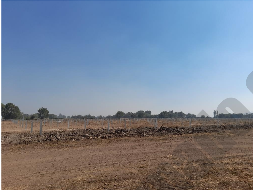
Figura 2. Cierre perimetral y trabajos de hincado en polígono Sur (cercano a receptores).
