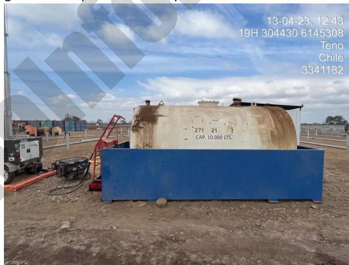
Figura 98. Estanque de combustible 10.000 L. Fuente: registro fotográfico terreno.
