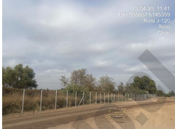
Zona de cierre perimetral temporal asociada a R4, la cual no se encuentra implementada.
