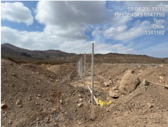
Figura 87. Estado actual de la malla en sector norte colindante al cerro. Fuente: registro fotográfico terreno.
