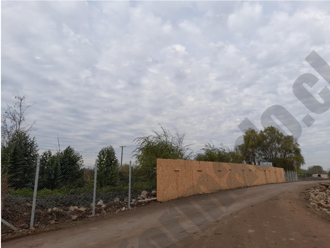
Figura 3c. Barreras acústicas implementadas en R4.
